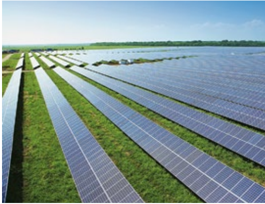
PV 16 MW A/C (24 MW D/C)
